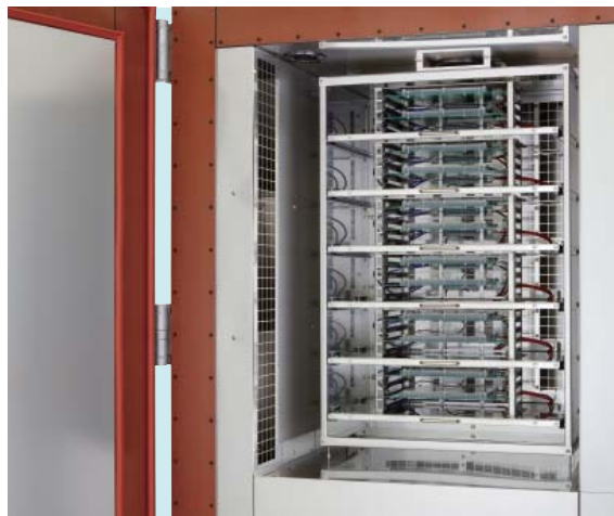
槽内(1槽タイプ)
